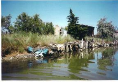
Berge dégradée au Salaison
